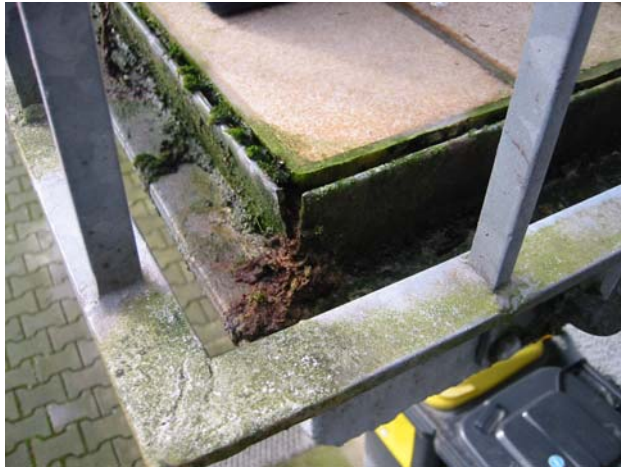
Balkonabdichtung ohne jegliche Funktion...
